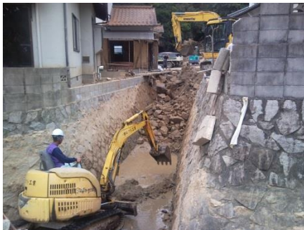
いまだ続く土砂撤去
